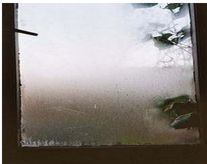
Condensación en una ventana
